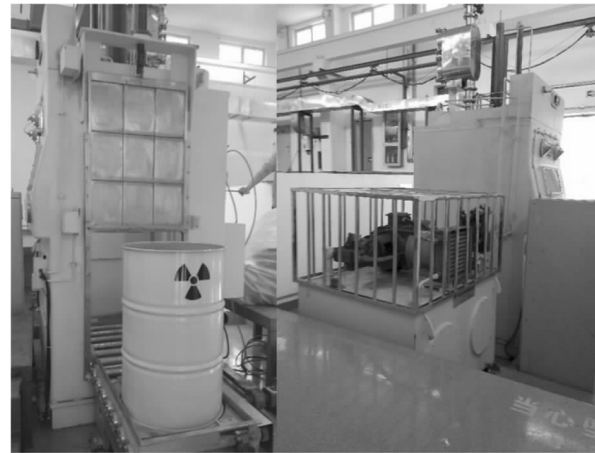
图 3 20 t 放射性固体废物压实装置
